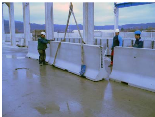
Vysunutie uvoľneného dielca zvodidla
